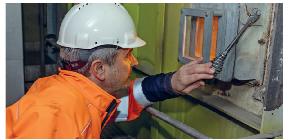
Die Hackschnitzel werden aus der ganzen Schweiz und dem süddeutschen Raum geliefert (oben), durch einen Schüttler ins System eingespeist (Mitte) und nach der Trocknung in grossen Öfen verbrannt (unten).
